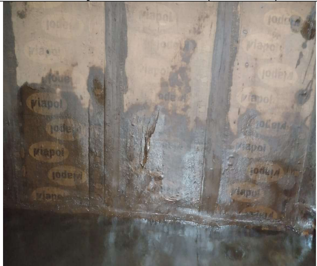
CONFORME MOSTRA A FOTO ACIMA A ÁGUA JÁ ESTA POR TRAZ DA MANTA DESSA FORMA NÃO AVENDO MAIS NEUMA FUNÇÃO DE IMPERMEABILIZAÇÃO NELA.
