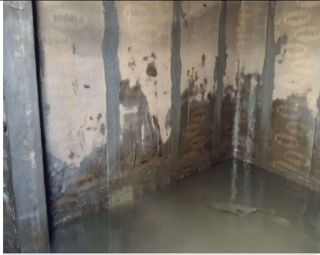
A MANTA APLICADA NÃO TEM NENHUMA PROTEÇÃO MECÂNICA. (REBOCO).
