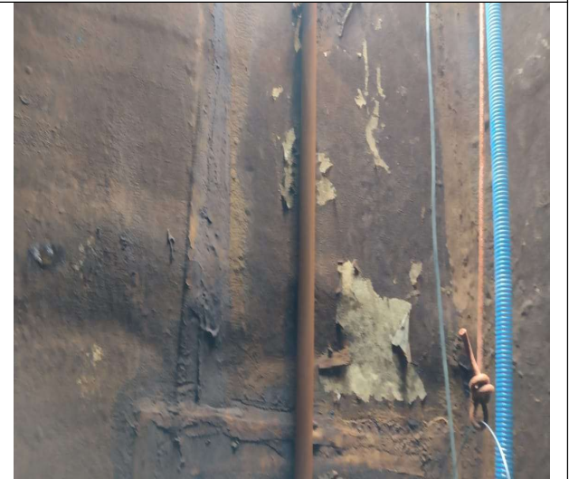
A MANTA ESTÁ LARGANDO SOZINHA DA PAREDE EM 90% DE SUA EXTENÇÃO POR FALTA DE PROTEÇÃO MECAICA.
